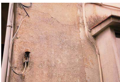
外壁のひび割れ ・コケ
