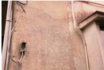
外壁のひび割れ・こげ
