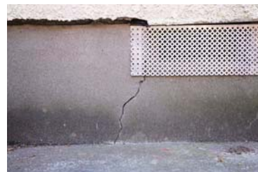
基礎のひび割れ
