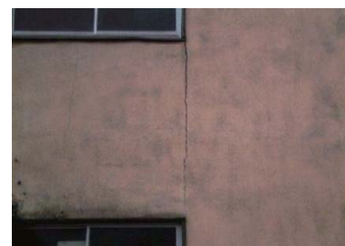
外壁の ひび割れ
