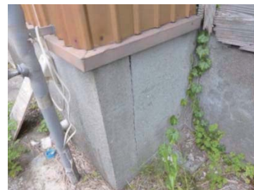
基礎の ひび割れ
