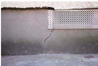
換気口付近の ひび割れ
