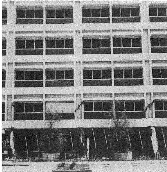
(d) 柱の損傷に伴う大きな水平変形の被害例
