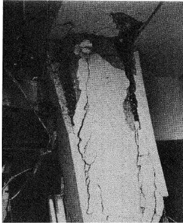
(a) 柱头混凝土剥落，铅直方向的主筋大范围的露出，沿着钢筋很大的裂缝延伸到中央。
