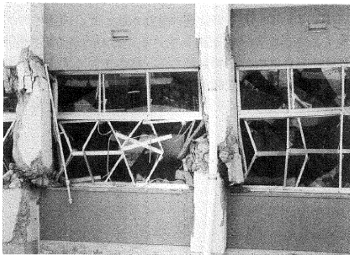
(b) 柱头以及柱脚弯曲，剪切破坏，高度方向产生变形。
